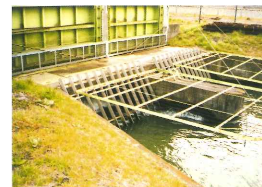
用水路のスクリーンパネル
