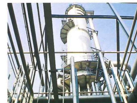
化学工場の配管
